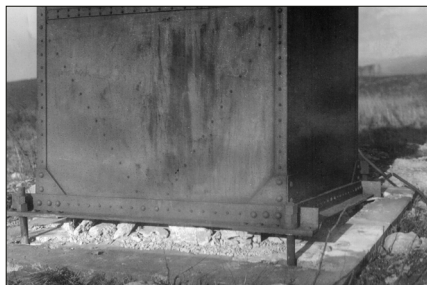
Poškození leteckého maják číslo 17 u Stupavy Foto NA, MVP, kart. 1387, 14a-596/6, 14114, 1935
